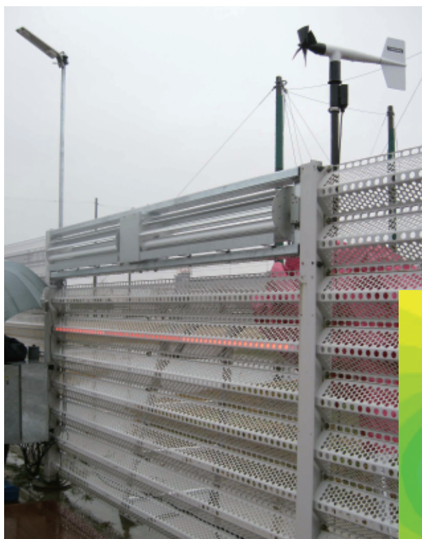
道路用有孔板式防風フェンス上部に設置した高性能クロスフロー風車による発電と誘導用赤色LEDランプ点灯のフィールド実験の様子 ((株)日本パーツセンター寺井工場内)
